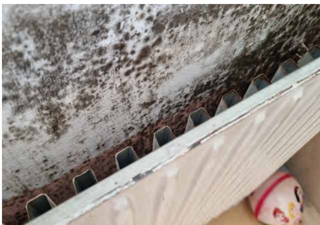
Ursachenermittlung 1: Wohnungsrundgang, Foto ©: Innenraumanalytik OG
