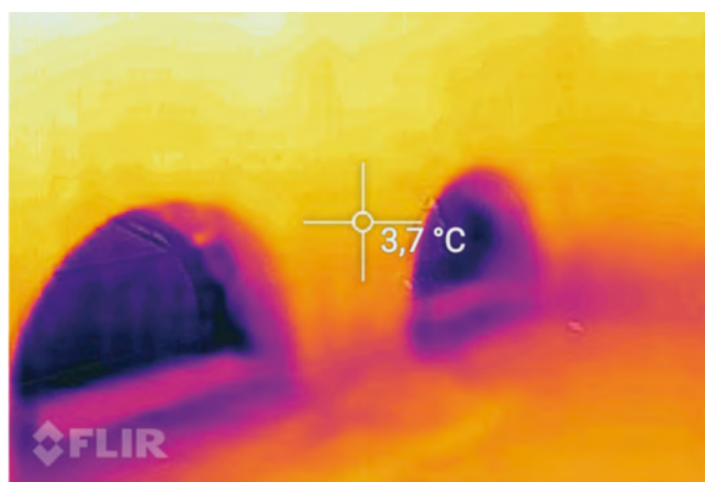
Abb. 8: Thermografieaufnahme zeigt raumseitig einheitliche Oberflächentemperaturen
