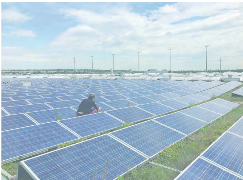
Abb. 2: Kombination eines Gründachs mit einer Photovoltaik-anlage, Foto ©: GrünStattGrau
