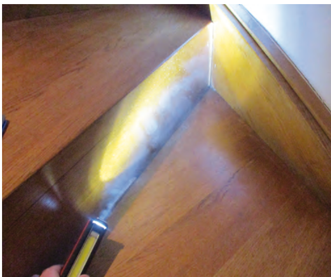
Kanalgeruch aus der Treppenfuge, Foto ©: Innenraumanalytik OG
