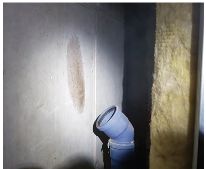
Kanalgeruch aus einer offenen Rohrleitung, Foto ©: Innenraumanalytik OG
