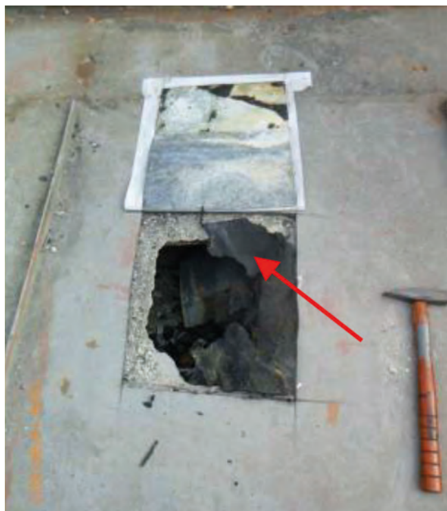
Abb. 3: PAK-haltige Teerpappe, Dachabdichtungsbahn Use Case 5 Quelle: RM Umweltkonsulenten
