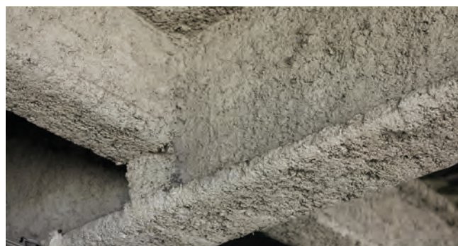
Abb. 4: Spritzasbest als Brandschutzbeschichtung von Stahlträgern Quelle: © Getty Images/iStockphoto/gyro
