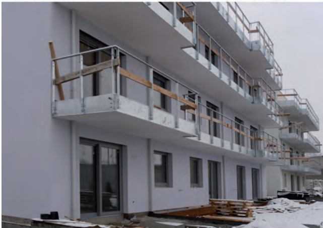
Baustelle Tulln: Abstimmung aller Fassadenelemente, Strukturierung des Baukörpers sowie Einbindung in die stark farbige, kleinteilige Umgebung. at home Immobilien-GmbH, Arch. Achtsnit. © Archicolor, P. A. Buxbaum
